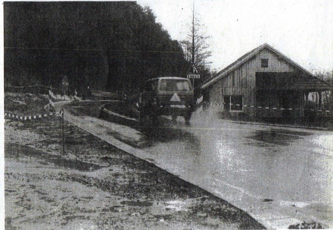
In den letzten Wochen und Monaten entstand das neue Generatorenhäuschen. Es fehlt noch der Generator. Foto: Winter
